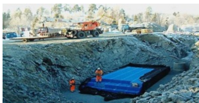
Fordrøyningsanlegg på Nadderud i Bærum med kassetter.
